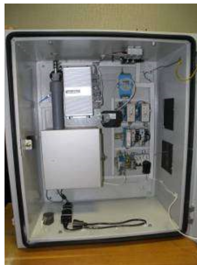
Рисунок 2 — Шкаф измерения поста контроля ШКК К-2040
